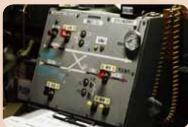
安全を守り続けてきた住吉公園駅の操作盤
